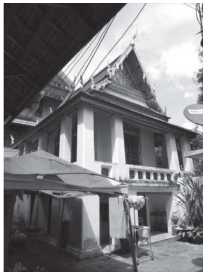
ภาพที่ 5 หอไตรด้านทิศเหนือ ในเขตสังฆาวาส ยังไม่ได้รับการซ่อมแซม การเข้าไปชมหอไตรต้องเดินผ่านหมู่กุฏิพระ สภาพหอไตรไม่ชำรุดมากนัก แต่ค่อนข้างรก มีการวางสิ่งของและตากผ้าไว้รอบหอไตร ที่มา: จักริน จุลพรหม
